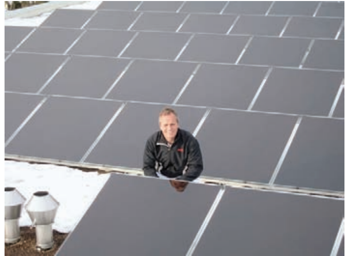
Solarzellen auf dem Flachdach
